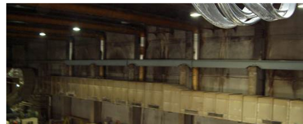
Die neue Kranbahn (grau), im Hintergrund die alte bestehende Kranbahn
