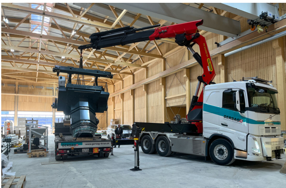
Aufbau des Stapelkrans Marco.
